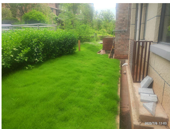
建筑周边排水
